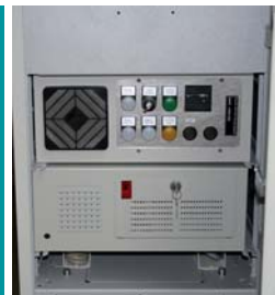
Steuereinheit und PC von vorne zugänglich
